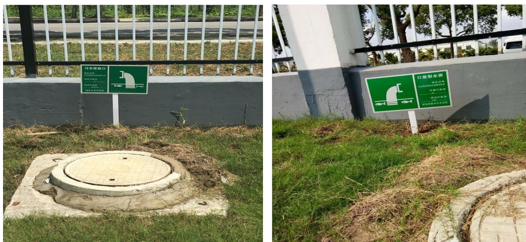
图 2-2 项目生活污水及雨水排水口
