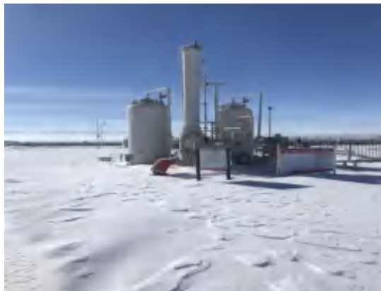
油气回收装置
