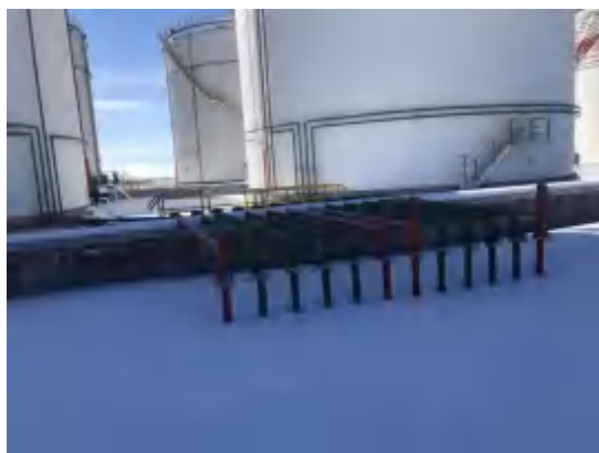
库区给水管线
