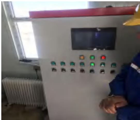
生活污水处理设施
